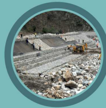
Gaviones de Protección
